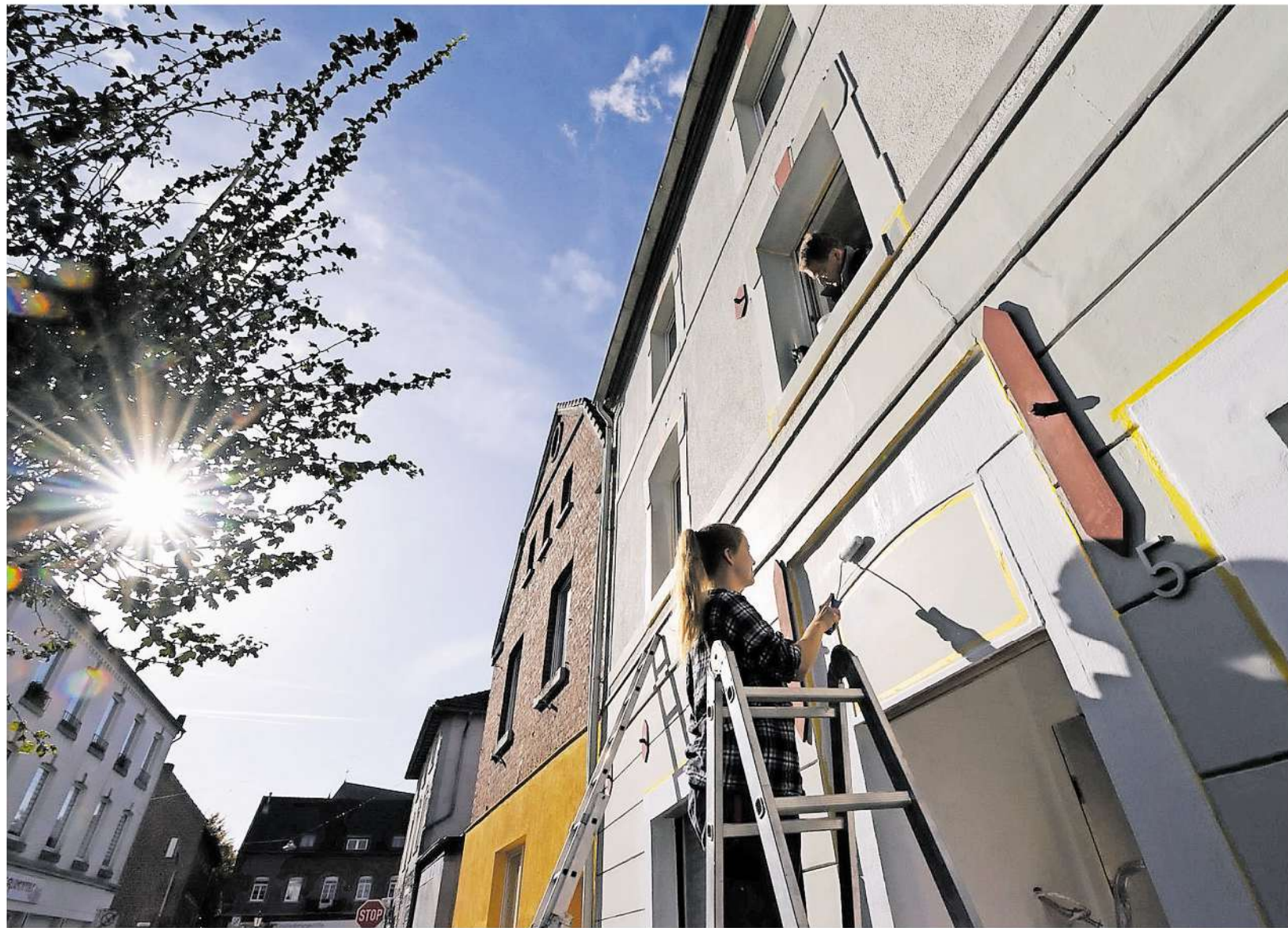
Der Ortskern Gangelt wird sich in den nächsten vier bis fünf Jahren stark verändern. Diese Hausbesitzer in der Heinsberger Straße haben schon mal mit ihrer Fassade angefangen.
